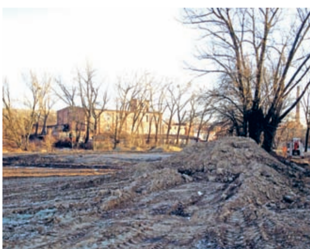
Ciechów – spod zwalów ziemi, w godnym podziwu tempie, zaczynają się wyłaniać zarysy nowego obiektu sportowego.
