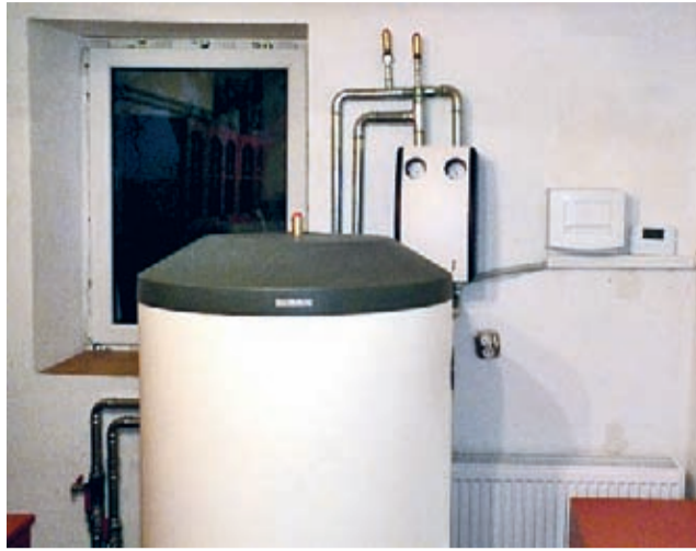
W Krynicznie świetlica wiejska została podłączona do pompy ciepła, na trwałe żegnając się z tradycyjnymi rozwiązaniami.
