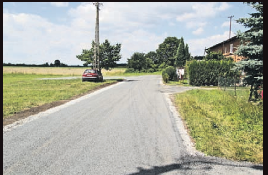
Budowa drogi transportu rolnego wraz z parkingiem w Zakrzowie, długość 299m - wartość 151 tys. złotych
