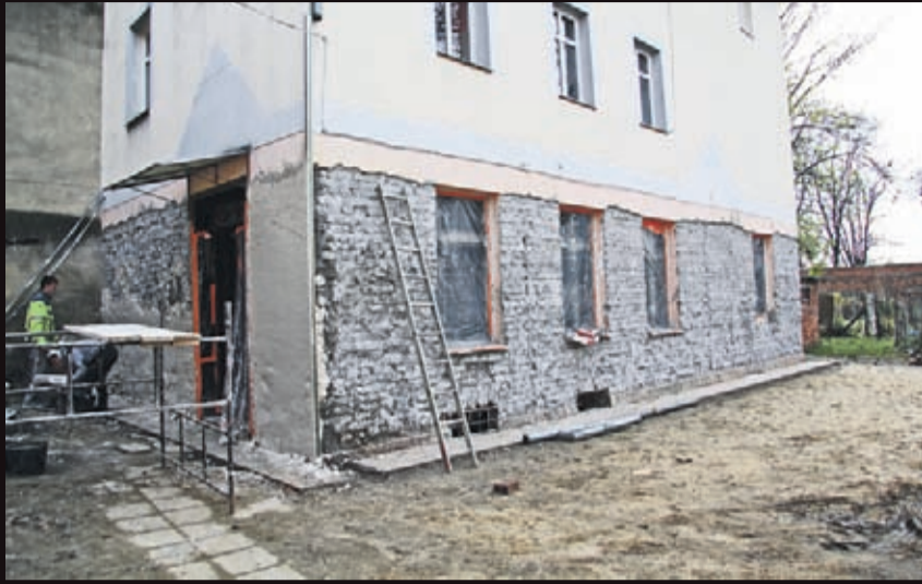
Remont elewacji budynku przy ul. Kościuszki 40A („Modernizacja części wspólnych budynków mieszkalnych wielorodzinnych stanowiących własność gminy” w ramach zadania „Rewitalizacja budynków wielorodzinnych w Środzie Śląskiej”). Wykonawca: firma Torus z Brzegu Dolnego.
