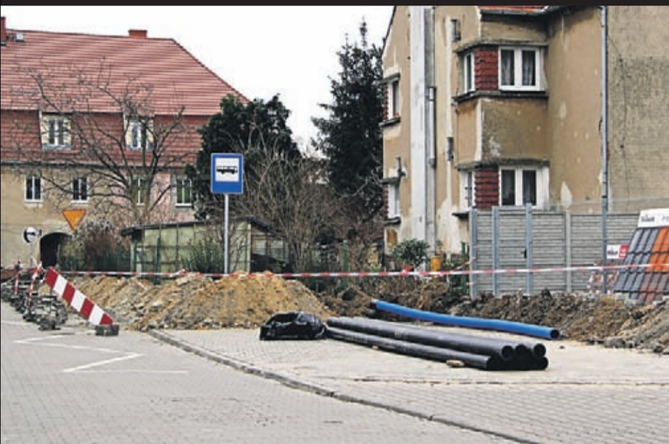
Montaż ładowarki dla autobusów elektrycznych komunikacji miejskiej przy ul. Spółdzielczej w Środzie Śląskiej. Wykonawca: firma Telfa ze Świdnicy.
