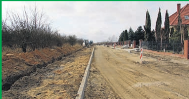
Budowa ul. Winogronowej w Środzie Śląskiej na odcinku od ul. Kilińskiego do ul. Sikorskiego wraz z kanalizacją deszczową. Wykonawca: firma FOBIS z Lubina.
