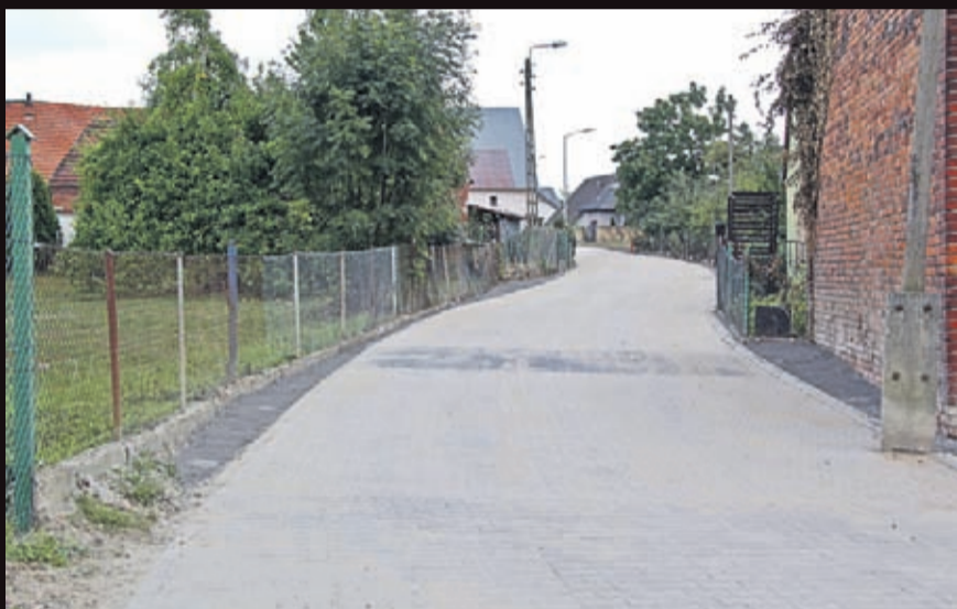
Budowa drogi na osiedlu Buczki w Ciechowie – etap II. Wykonawca: HEMIZ-BIS z Prochowic.
