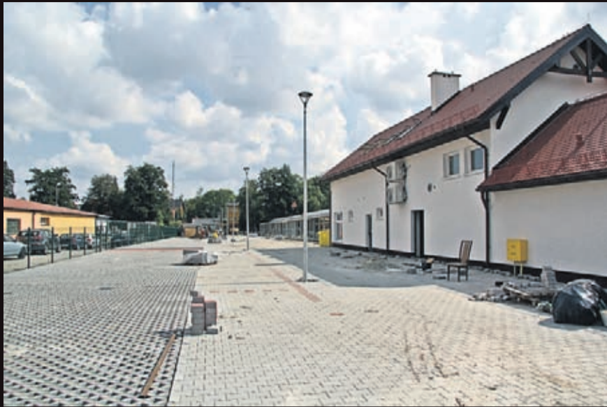
Przebudowa targowiska miejskiego w Środzie Śląskiej. Wykonawca: P&D Przemysław Drabik z Brzegu Dolnego.
