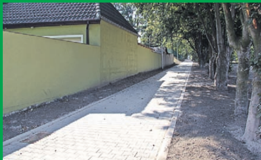
Przebudowa al. Janusza Korczaka w Środzie Śląskiej. Wykonawca: INSTALATOR ze Środy Śląskiej
