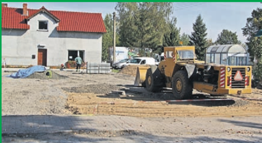
Budowa parkingu przy skrzyżowaniu ulic Średzkiej i Lipnickiej w Szczepanowie. Wykonawca: HEMIZ-BIS z Prochowic.
