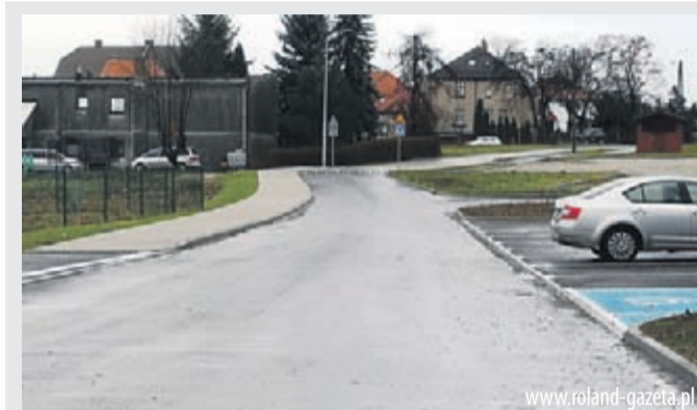
Budowa łącznika ul. Wierzbowej i Cmentarnej w Środzie Śląskiej z chodnikami i parkingami Wartość zadania – 692 000 zł
