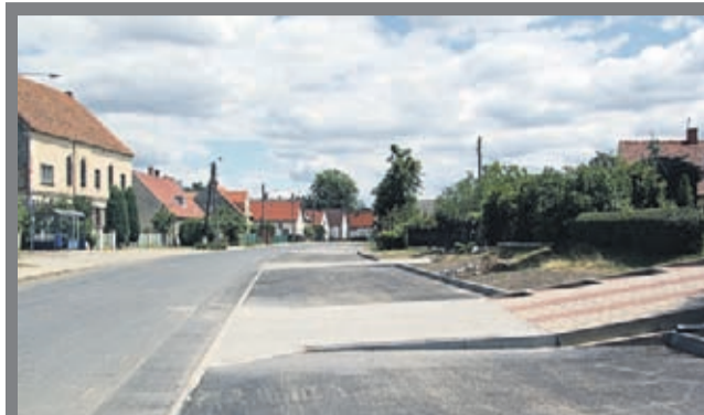
Budowa miejsc postojowych ze zjazdami przy świetlicy wiejskiej i OSP w Brodnie Wartość zadania – 258 000 zł
