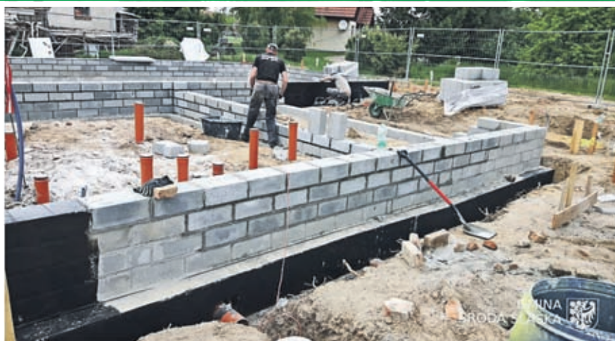
2. Budowa świetlicy wiejskiej w Kobylnikach Wartość inwestycji: 795.381 zł. Wykonawca: EL-SOL INSTALACJE z Lubczy.
