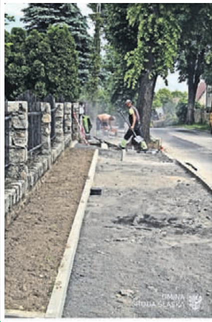
3. Budowa chodnika przy ul. Cmentarnej w Środzie Śląskiej Wartość inwestycji: 134 592 zł. Wykonawca: HEMIZ BIZ Sp z o.o. z Prochowic
