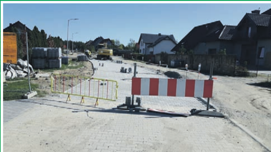
„Budowa drogi na osiedlu Buczki w Ciechowie-Etap III” Wartość inwestycji: 337 239zł. Wykonawca: GLOBISTIC,
