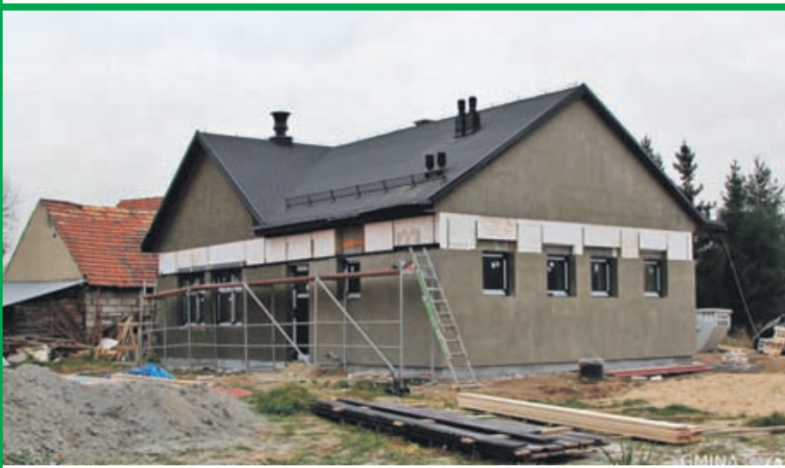
2. Budowa świetlicy wiejskiej w Kobylnikach Wartość inwestycji: 795.381 zł. Wykonawca: EL-SOL INSTALACJE z Lubczy.
