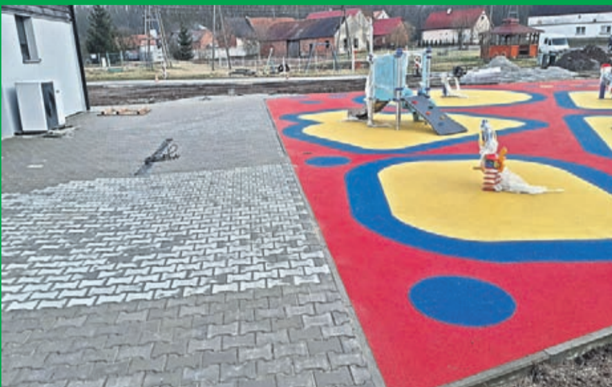
2. Budowa świetlicy wiejskiej w Kobylnikach - zagospodarowanie terenu Wartość inwestycji: 795.381 zł. Wykonawca: EL-SOL INSTALACJE z Lubczy.
