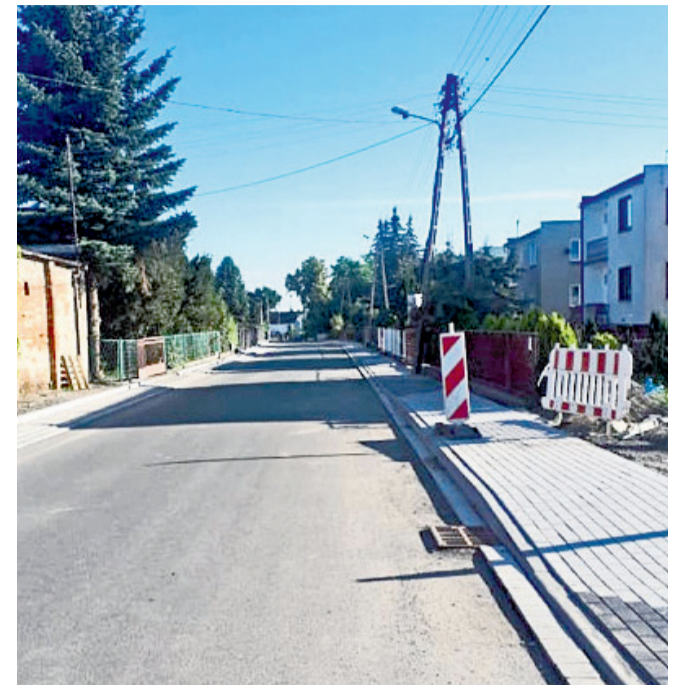
Dobiegają końca prace przy przebudowie ulicy Willowej w Miękinii. Wykonano chodniki, położono warstwę wiążącą, trwają prace związane z ułożeniem warstwy ścieralnej. Zgodnie z umową z wykonawcą prace zakończą się do połowy sierpnia.
