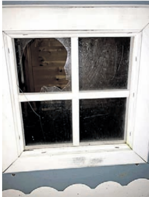
Wybite okno w drewnianym domku na placu zabaw w Komornikach
