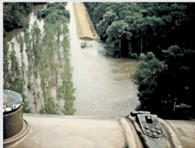
Wyrwa wałowa na wysokości miejscowości Słup/ Fot. H. Graboń
