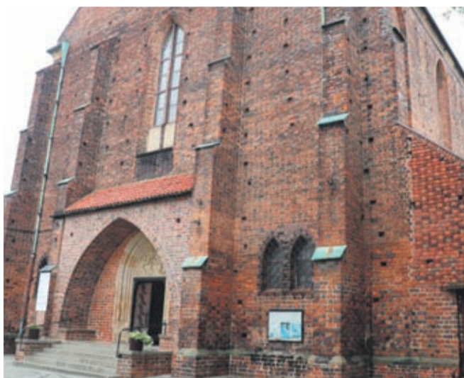
Niedługo mają ruszyć konserwacja szczytowej ściany kościoła pw. Podwyższenia Krzyża Świętego w Środzie Śl.
