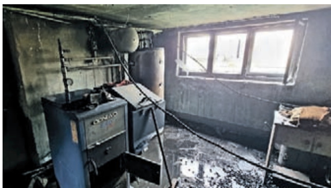
W wyniku pożaru zniszczeniu uległy pomieszczenia piwniczne w budynku mieszkalnym.
